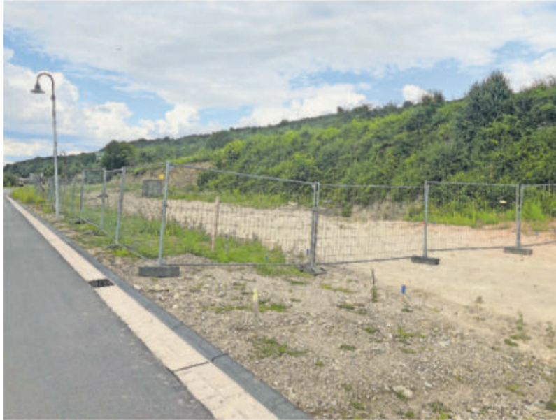
Dieses Baugrundstück im Neubaugebiet Unter dem Farsterweg in Wellen ist bei einem Starkregen eingestürzt.
